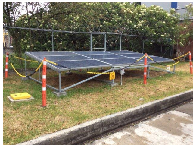
Fig. 9. Ubicación de los paneles solares dentro de una de las subestaciones de alta tensión de CODENSA. Usualmente se instalaron arreglos de 9 paneles solares para una potencia pico de 2655 Watts.
