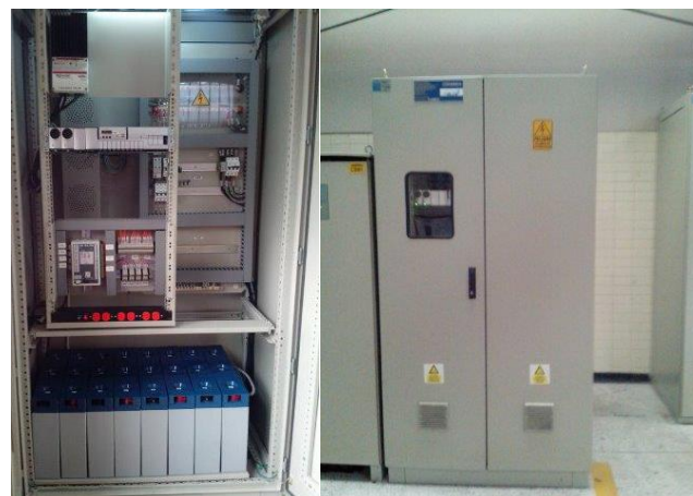
Fig. 10. Distribución interna de los equipos en el gabinete del sistema de gestión de corriente continua y aspecto exterior del mismo. Los diseños implementados cumplen con todas las normas de instalaciones eléctricas dentro subestaciones de alta tensión..
